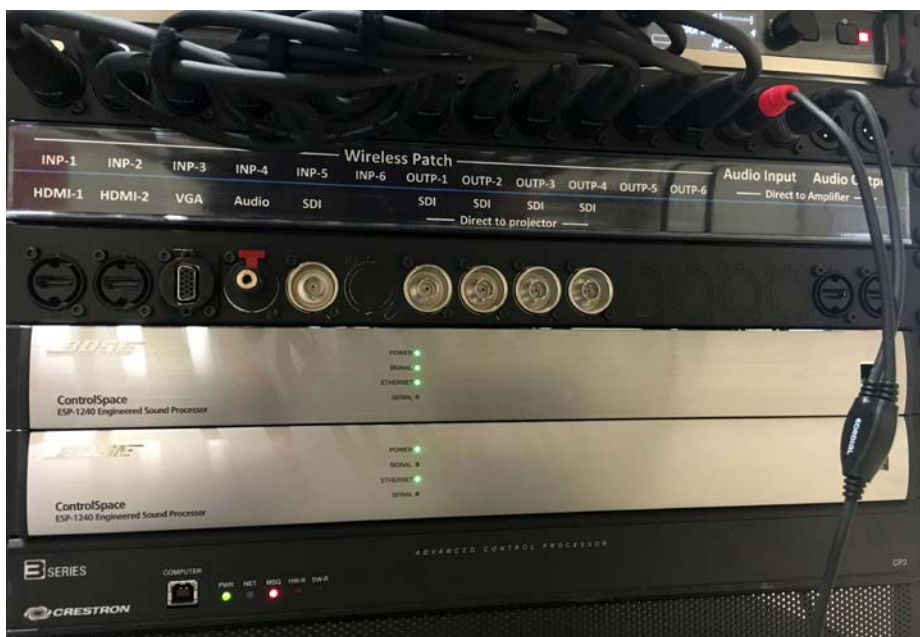
Här kan vi se Bose ControlSpace ESP-1240 vilande i sitt rack. Under den har en Crestron CP3 skjutits in.
