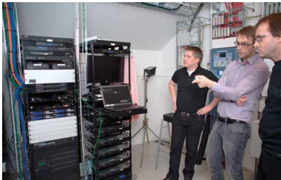
Styrningen av ljud, ljus och bild är integrerad. Styrssystemet är baserat på Crestrons nätverk Digital Media. Petter Jarbo, Charlie Fält och Carl-Fredrik Malmgren kollar en detalj i teknikrummet.
